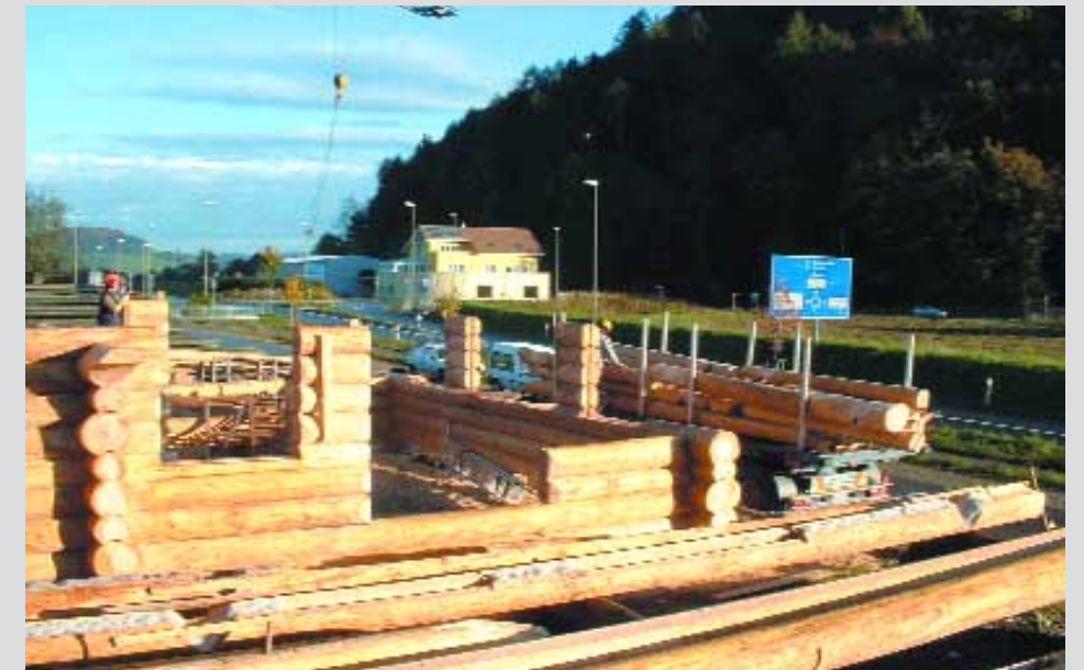
Die Produktion des Blockhauses auf dem Bauplatz in der Tallage bei Willisau.
