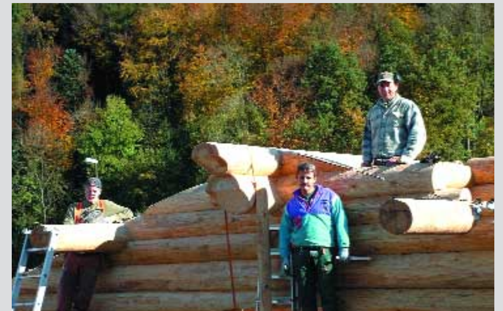
Die Crew der Alaska Blockhaus aus der Schweiz kurz vor Abschluss der Arbeiten.
